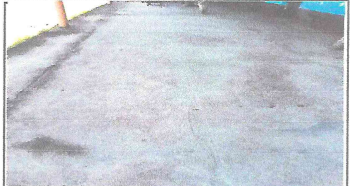
Foto 2: Piso en mal estado
