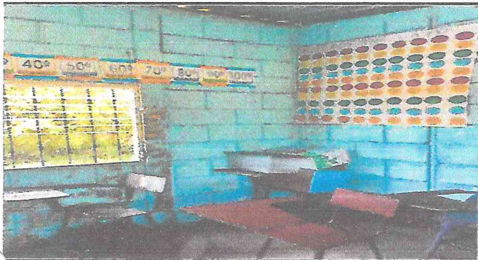
Foto 1: Piso en mal estado
